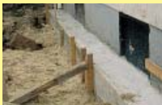
Für eine nachträgliche Verblendung kann die Anlegung eines Streifenfundaments erforderlich sein oder das Anbringen einer Abfangkonsole zum Auflagern.
